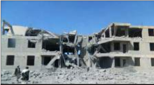
صورة موثقة تظهر جانب من الدمار الذي تعرض له المبنى المستهدف
