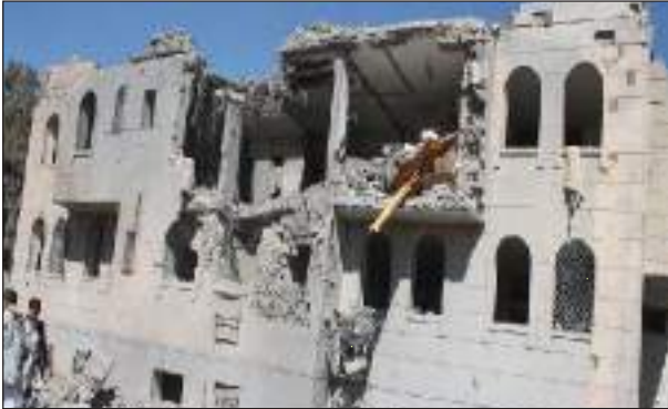
صورة موثقة تظهر جانب من الدمار الذي تعرض له المبنى المستهدف
