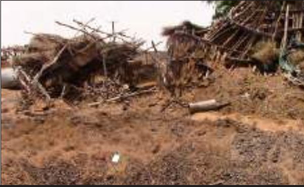
صورة موثقة تظهر جانب من الدمار الذي لحق بمنزل المواطن (أحمد علي عضابي)
